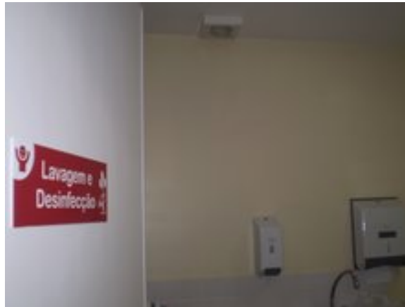
Figura 3. Sistema de exaustão no teto da sala de lavagem e desinfecção.
